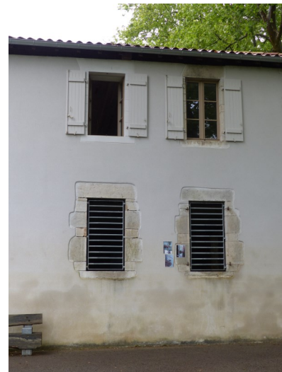
▲ Les ouvertures du RDC peuvent laisser passer l'eau
