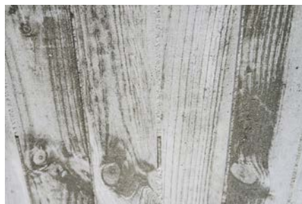
Les maçonneries en béton sablées rendent visibles les traces de coffrage en bois.
