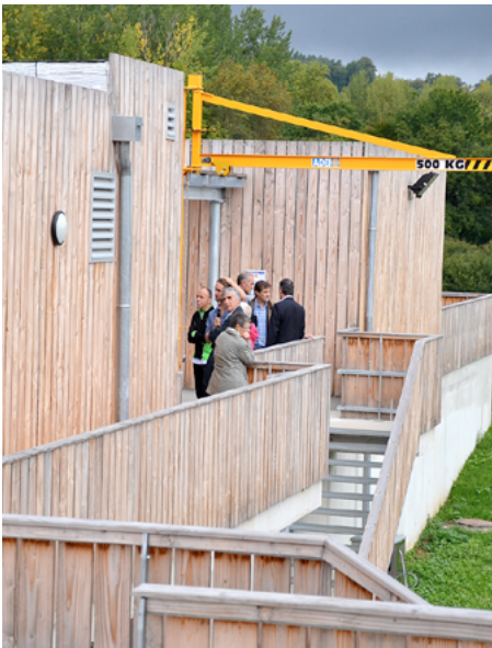
▲ Équipements techniques habillés de bois brut
