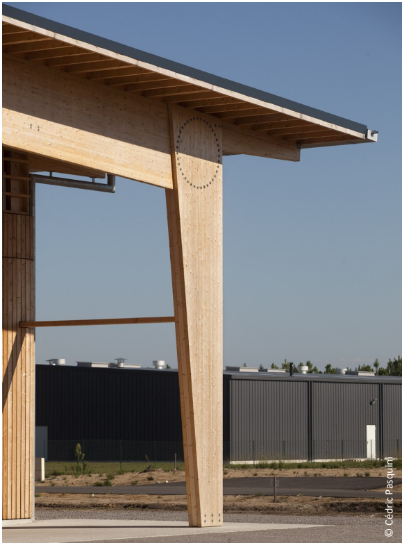
▲ Élément structurel en lamellé collé
